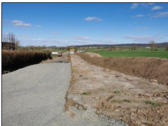
Abb. 7: Der ehemalige Grasweg im Westen des Plangebietes wird bereits im Zuge der Erschließungsarbeiten zum angrenzenden Baugebiet „Sonnenblick“ ausgebaut.
